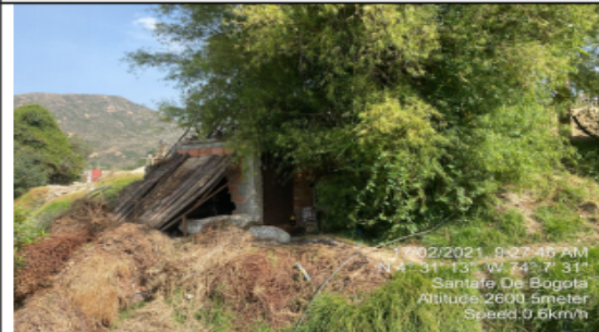
Fotografía No. 3. Caseta o garita de electrobomba.
