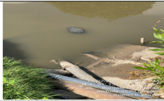
Fotografía No. 3. Estructura de captación de aguas superficiales del río Tunjuelo.
