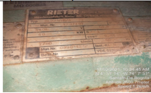
Fotografía No. 4. Placa del equipo al cual se le imponen sellos.
